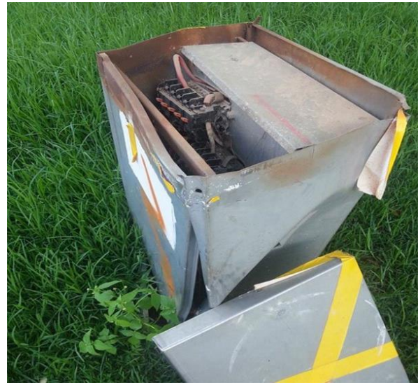
City Power mini sub-station
